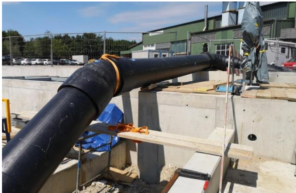
Abb. 24: provisorische Zuleitung zur Vorklärung
