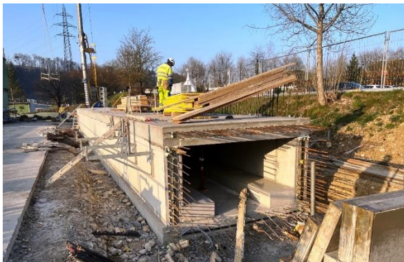
Abb. 20: Zulaufkanal ARA Zwingen
