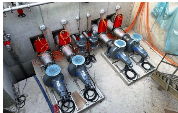
Abb. 23: Rohwasserpumpen im Hebewerk
